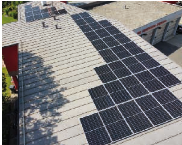
Neue Photovoltaikanlage am Dach der Feuerwehr Himberg
